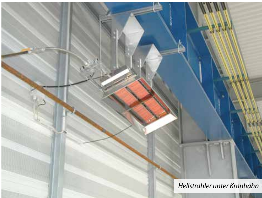
Direktbeheiztes Lüftungssystem in Werkstatthalle
