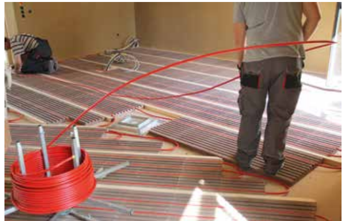
Heizschlaufen, in Tonelementen verlegt, temperieren die Böden auf 22 Grad. Der Vorlauf bleibt unter 26 Grad.
