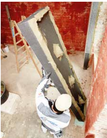
Energieeffizienz von innen: Die Außenwände wurden mit der hoch wärmedämmenden Verbundplatte Rigi Therm-032 von Rigips gedämmt.
