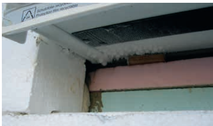
Abbildung 1: Gefrorenes Kondensat unter der Außenfensterbank
