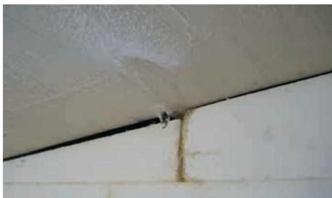
Abbildung 2: Gefrorenes Kondensat an der Dachuntersicht
